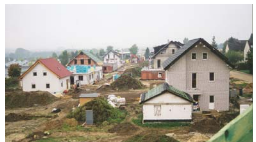
NEH-Siedlung Detmold-Kreuzstraße 1999-2002 32 EFH. Qualitätssicherung und Nahwärme- Contracting durch NEI Detmold 60 % CO 2 -Einsparung (NEH +Nahwärme)
