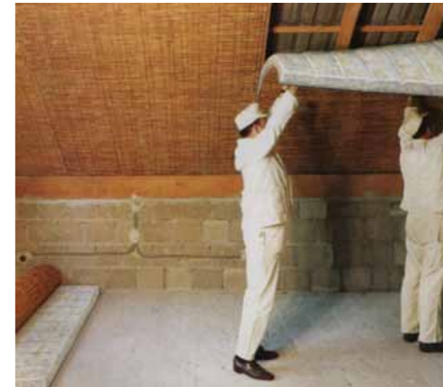
Abb. 2 Nur mühevoll über zwei Sparrenfelder in Überkopfarbeit zu befestigen: Die ersten Glaswollebahnen für die Untersparrendämmung in den sechziger Jahren.
