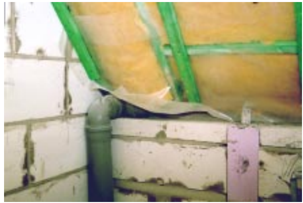
Bild 6.5- 13: Ebenfalls aus Platzmangel ungelöste Abdichtung zwischen Rohrleitung und Folienebene. Rohrverlegung in Außenecke des Raumes behindert auch den luftdichtenden Innenputz.
