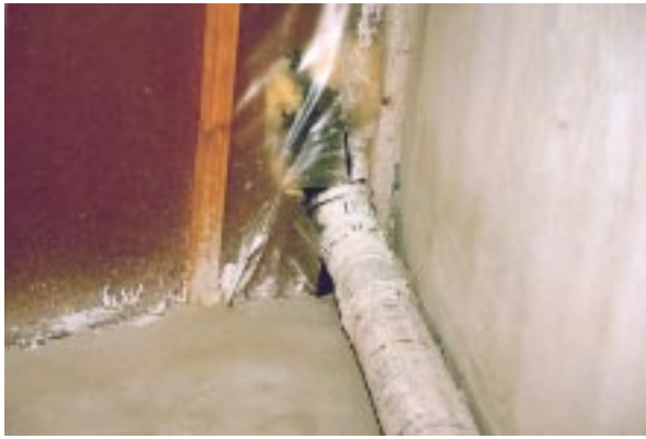
Bild 6.5- 12: Zu stark in die Ecke gequetschtes Fallrohr lässt sich nicht an die Folie andichten.
