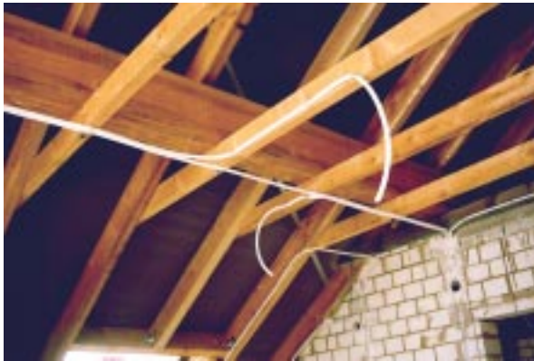
Bild 6.5- 6: Strom-Hüllrohre an Sparren genagelt behindern spätere Verlegung der Folie.
