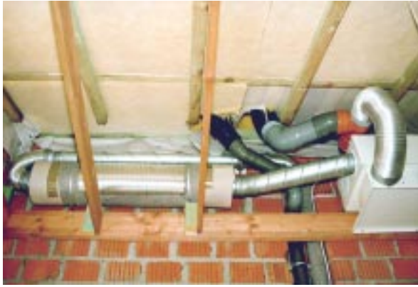
Bild 6.5- 19: Beengte Montage und Leitungsführung einer Abluftanlage mit undichter Durchdringung der luftdichtenden Folienebene.
