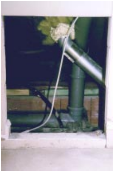
Bild 6.5- 14: Pseudo-"Abdichtung" zwischen Lüftungsrohr und Folie mittels Ortschaum.
