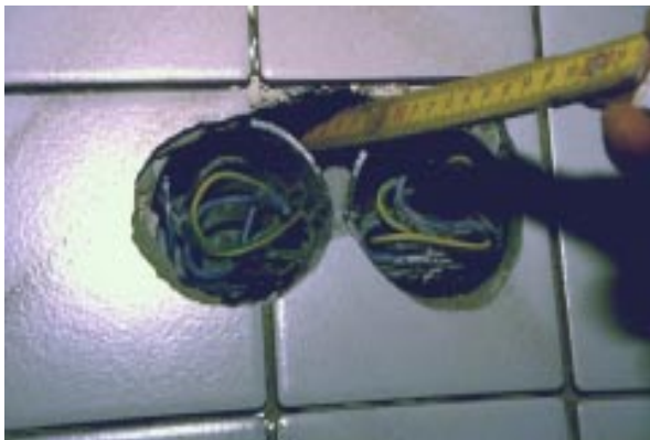
Bild 6.5- 8: Steckdose in Hohlsteinwand mit starker Luftundichtheit..
