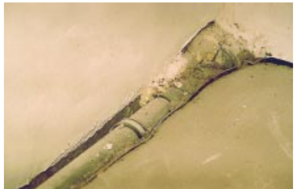
Bild 6.5- 11: Abwasserleitung zu nah an Wand verlegt behindert luftdichten Putz an Außenwand.
