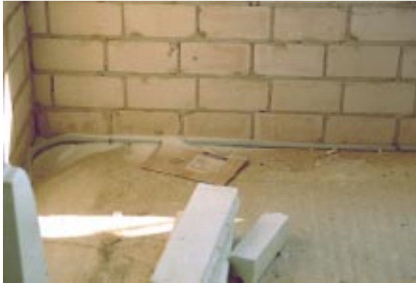
Bild 6.5- 4: Strom-Hüllrohr direkt an Außenwand behindert vollflächiges Verputzen.
