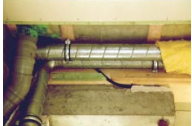
Bild 6.5- 20: Direkt benachbarte Durchdringungen mehrerer Leitungen erschweren die Anarbeitung der Luftdichtung.
