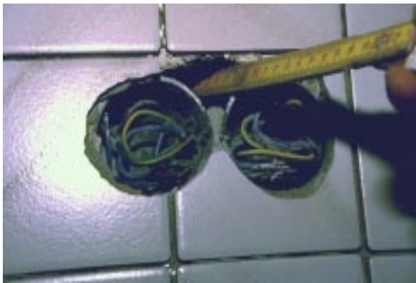
Bild 6.5- 8: Steckdose in Hohlsteinwand mit starker Luftundichtheit..
