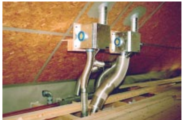
Bild 6.5- 18: Rohrdurchführung durch die luftdichtende Holzwerkstoffplatte im Schrägdach mit glattwandigen Rohren und Baupappe-Abklebung.
