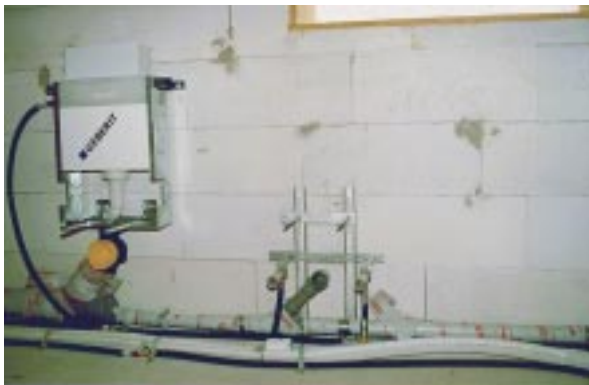
Bild 6.5- 10: Vorwandinstallation auf unverputzter Außenwand ergibt starke Luftundichtheit.
